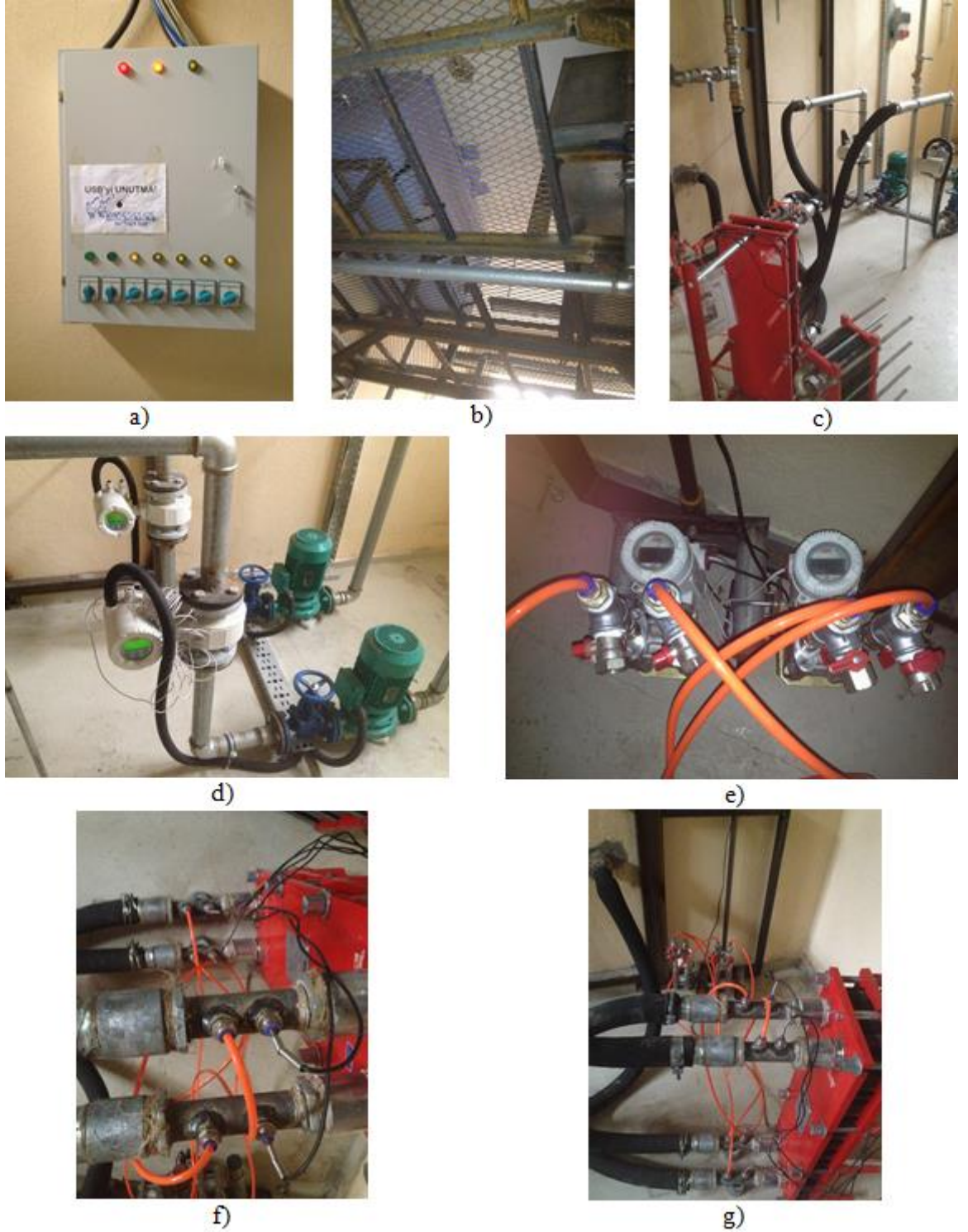
Şekil 4.2. Kurulu deney düzeneği fotoğrafları, a) elektrik panosu, b) sıcak ve soğuk su tankları, c) ısı değiştirgecinin esnek borular ile bağlantısı, d) elektromanyetik akışölçer ve pompalar, e) fark-basınç ölçerler, f) ısılıçift ve basınç ölçerlerin ısı değiştirgeci girişine bağlantıları, g) elastik boru bağlantıları.
